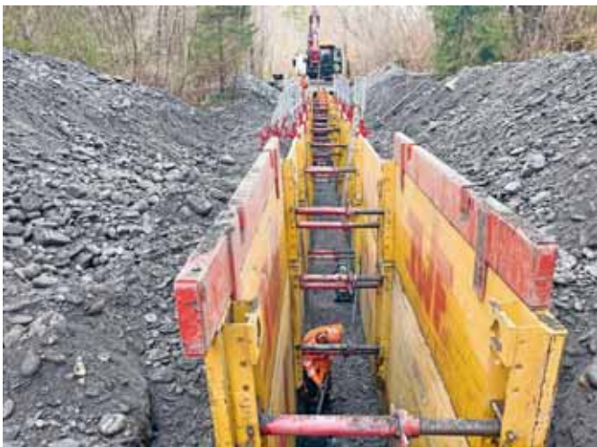
Abbildung 12: SW-Leitung Tamina – Ausserfeld
