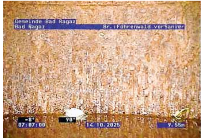
Abbildung 25: Blick auf die verschlossenen Filterschlitzte
