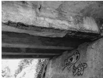
Unterbau der Sandbrücke mit Betonrissen.
