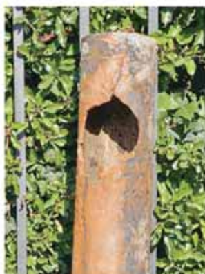
Beschädigte Leitung an der Bahnhofstrasse
