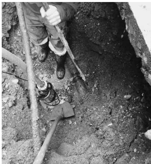
Der Bruch an der Wasserleitung GG Ø 70/85 in der Metzgergasse wird repariert.
