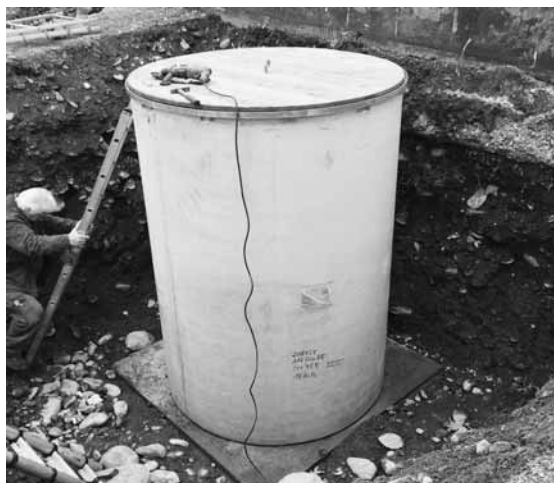
Der erste öffentliche Unterflur-Abfallbehälter vom Typ Trashfox Integral wird in Position gebracht und installiert.
