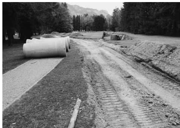
Die Betonrohre für den eingedolten Niklausenbach im Bereich Golfweg – Abschlag Bahn 10 liegen bereit.
